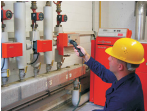
Überprüfen der Temperatur an Heizkreisen
