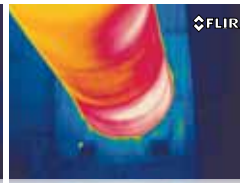
Zusammenbruch der feuerfesten Auskleidung eines Drehrohrofens
