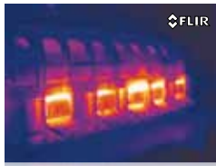
Defekt der feuerfesten Auskleidung
