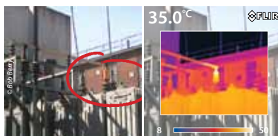
Inspektion des Transformators mit der Bild-in-Bild-Funktion.
