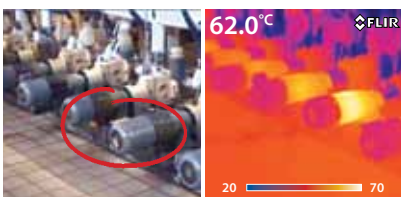
Mechanische Überprüfung eines Elektromotors.
