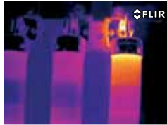
Innere Beschädigung einer Sicherung
