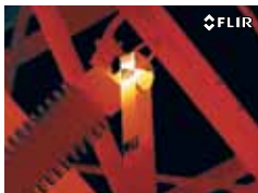
Fehlerhaft befestigte Verbindung
